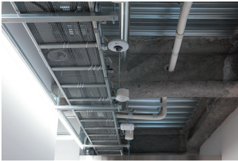
図23 配管がむき出しになっている天井
