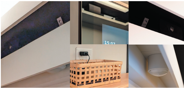
図46 天井に設置されたカメラやセンサー
